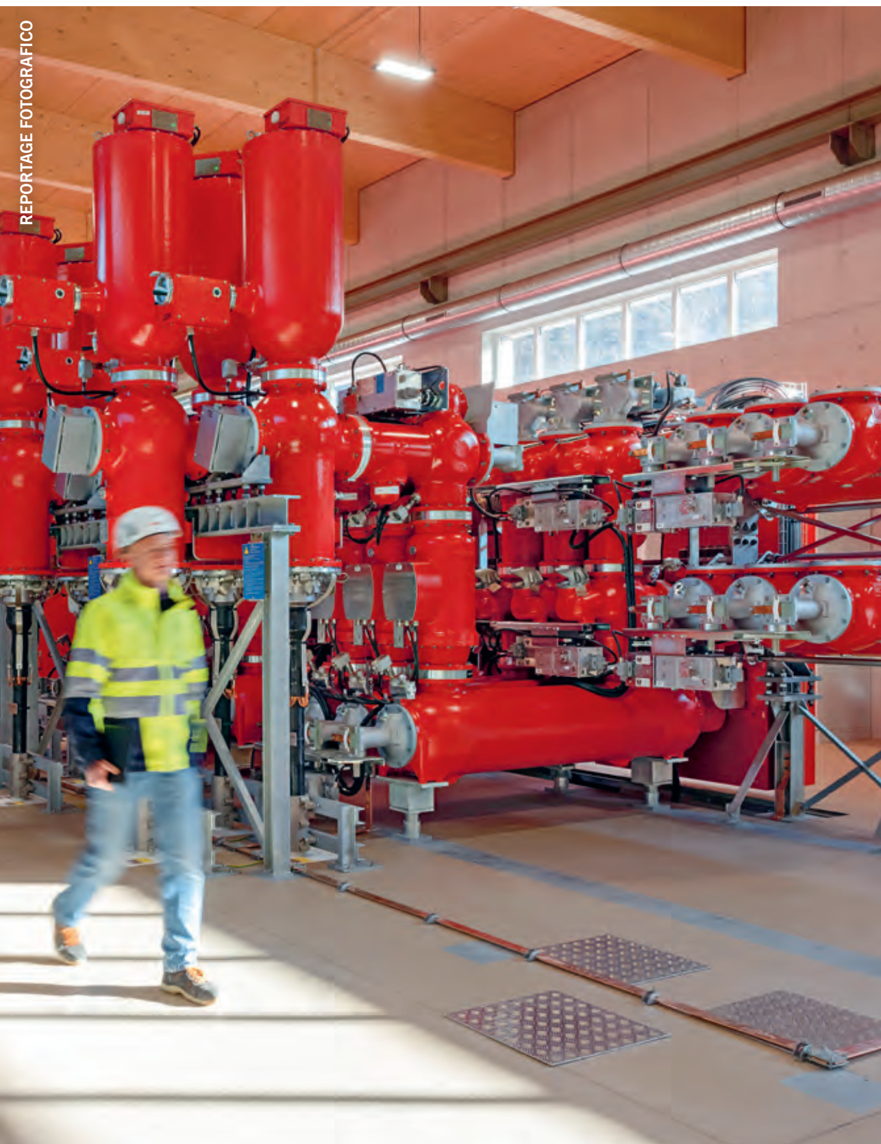
Infrastruttura. La sicurezza di funzionamento della rete di trasmissione dipende dalla funzionalità dell'infrastruttura.
